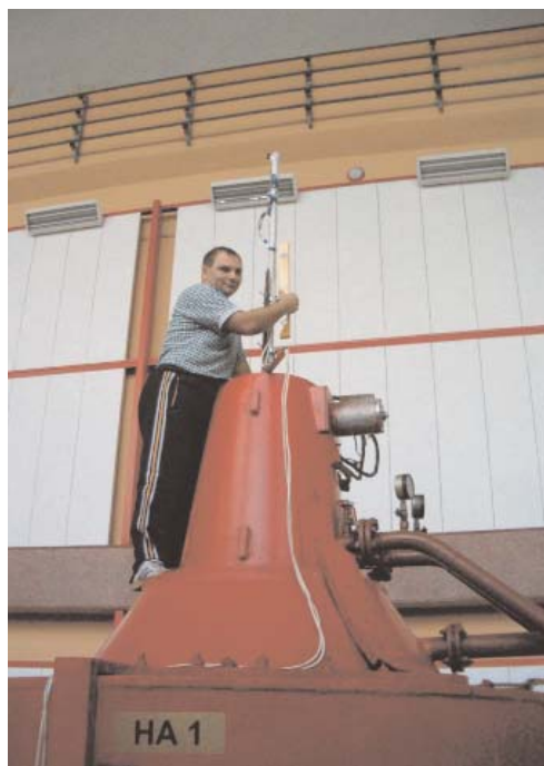
Montare traductor de deplasare pentru cursa servomotorului rotorului turbinei de la HA1 Centrala Hidroelectrică Turnu
